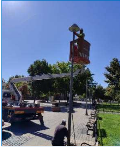
Zeynel Abidin Türbesi Çev. LED Dönüşümü
